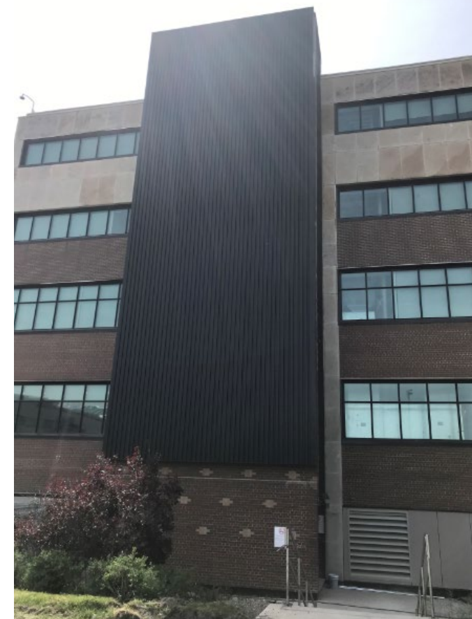
Mur solaire installé dans l'un de nos immeubles du siège social à Ottawa.
